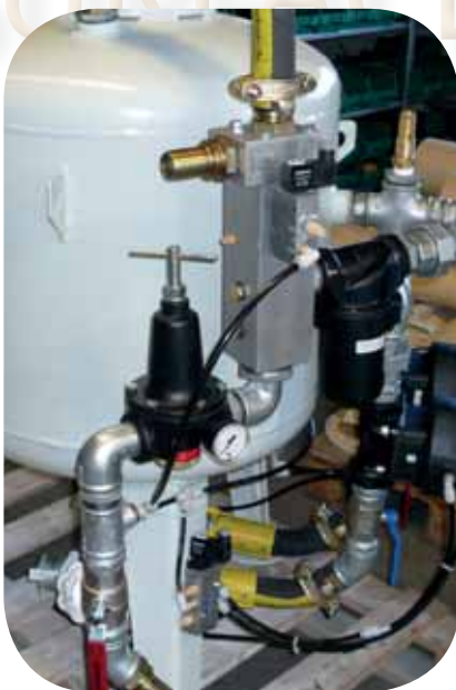
Kombiventil im Einsatz am SES Kessel
